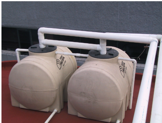
Tanques plásticos y tuberías.
