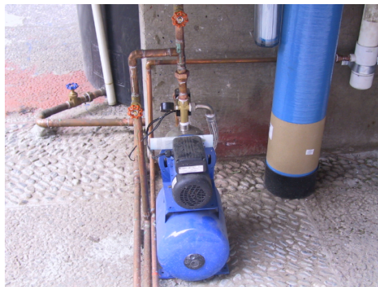
Equipo de bombeo electromecánico
